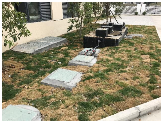
管理区生活污水处理装置
