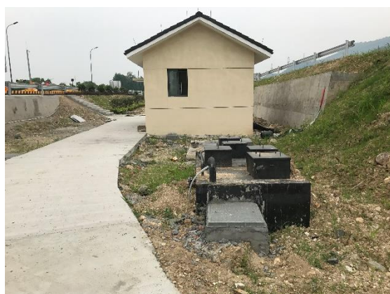
污水处理设施
